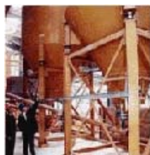
Básculas de Tolva y Tanque
